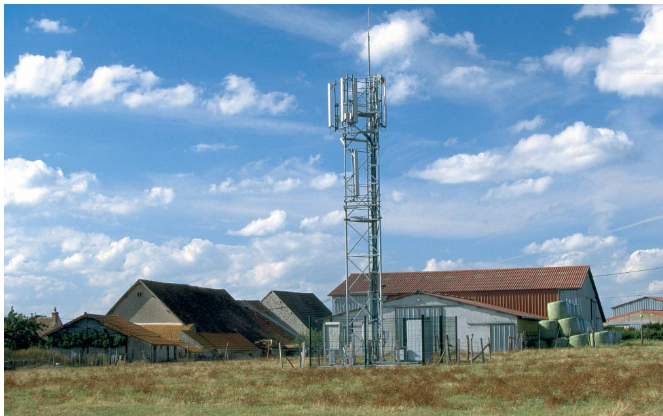
Une antenne relais pour la téléphonie mobile GSM, en campagne, sur exploitation agricole. (Cliché REA)
